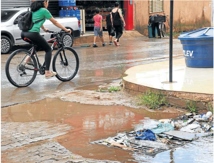
Entulho e lixo entopem os bueiros e bocas de lobo da Estrutural
