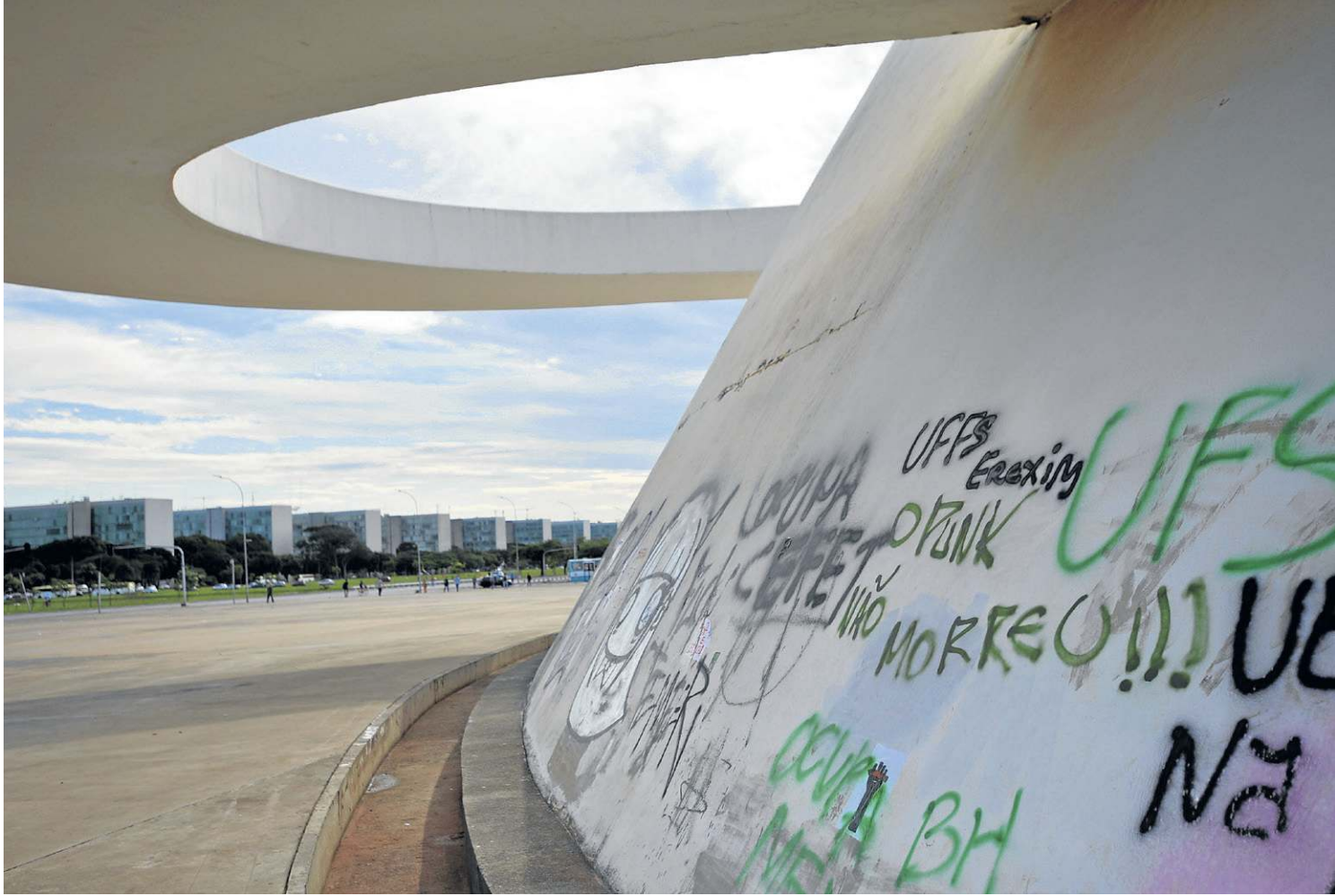
Atos de vandalismo, como pichações, são um problema antigo na cidade, conforme mostra esse registro no Museu Nacional da República em 2016
