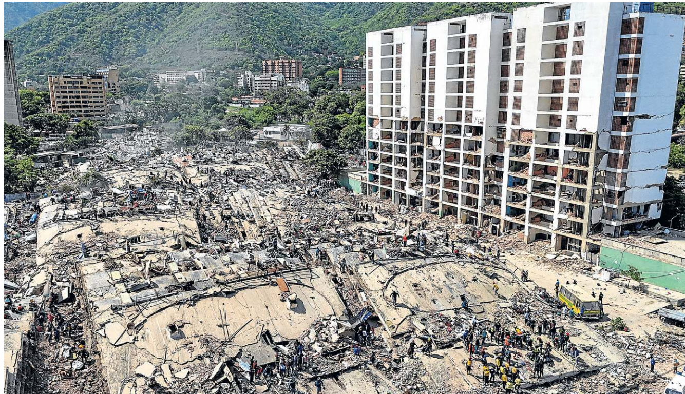
Imagem aérea mostra equipes removendo os escombros de um prédio em Caraballeda, também em La Guaira: devastação
