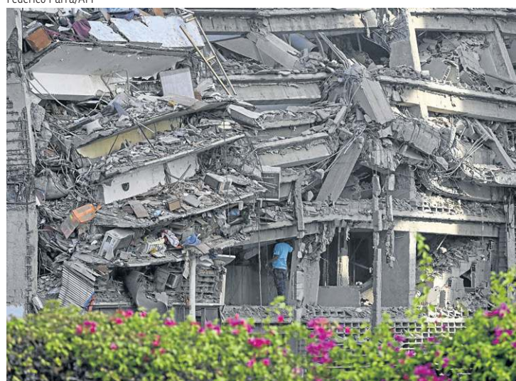
Homem inspeciona prédio colapsado, também em La Guaira: cenário de destruição
