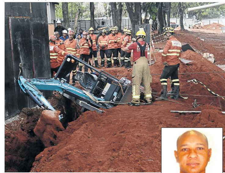
Máquina tombou sobre a vala onde Genilson estava. Ele deixa esposa e dois filhos
