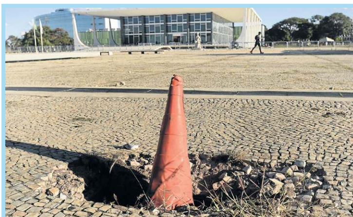
Parte ainda não restaurada apresenta rachaduras, buracos à mostra e sujeira
