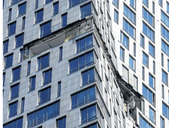
Dano em prédio residencial provocado por um ataque com um dos aparelhos em Moscou
