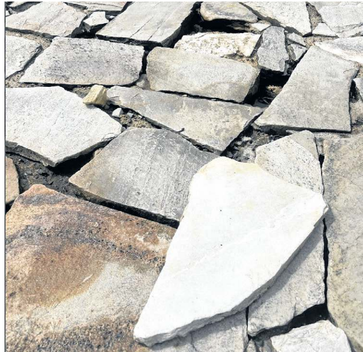
Condições físicas da estrutura impedem funcionamento
