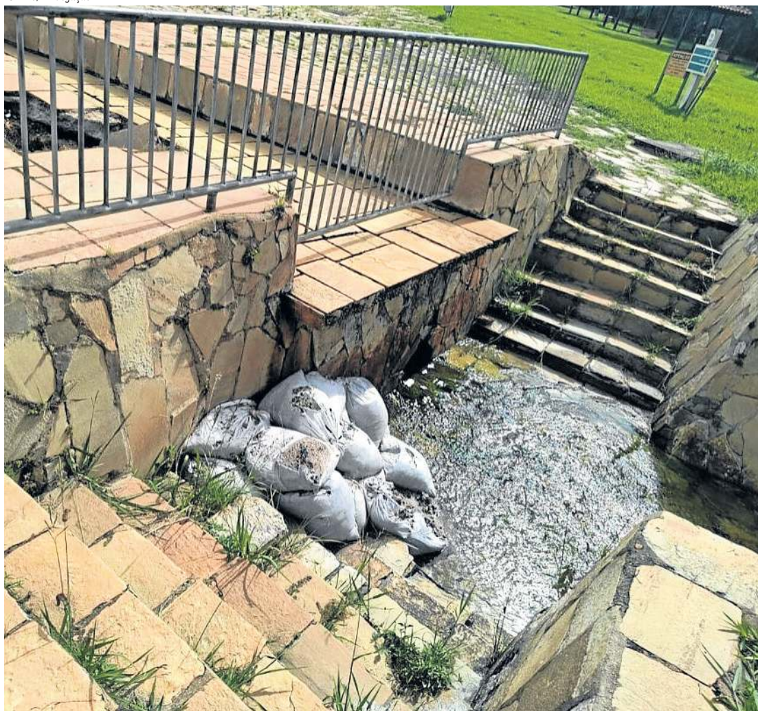
Parte do sistema de escoamento da piscina Areal cedeu; essa é a interdição mais longa desde a pandemia
