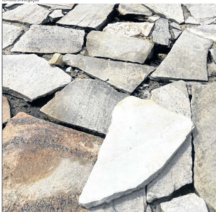
Condições físicas da estrutura impedem funcionamento
