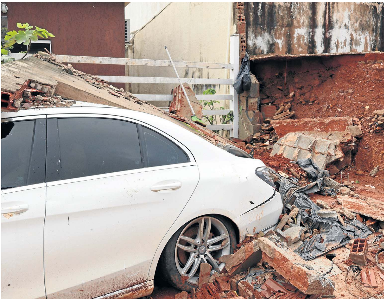
Força da chuva derrubou um muro de 6 metros de altura sobre um carro estacionado na garagem em Vicente Pires
