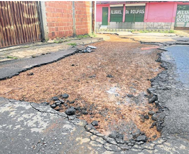
Chuva deixa estragos na rua 2 do Condomínio Privê...
