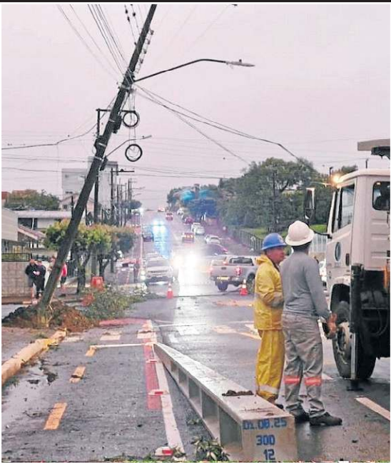
Danos à rede elétrica foram registrados em Xanxerê (SC)
