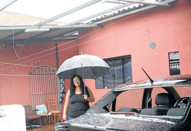
Parte da cobertura da garagem de Marizete cedeu e atingiu o carro
