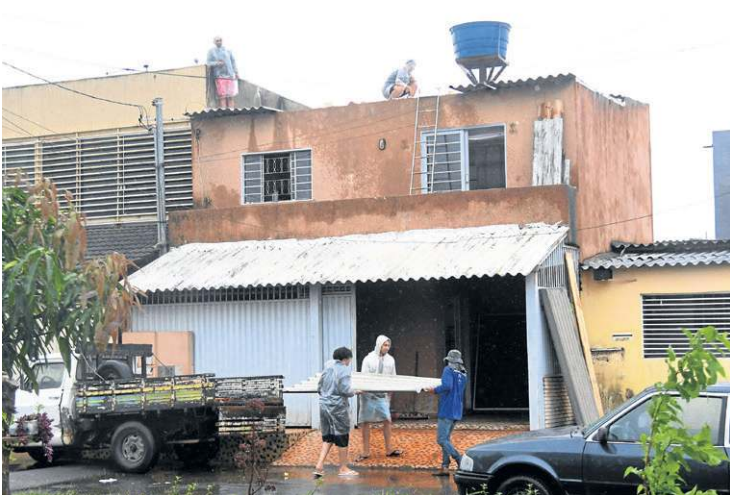
O dono do imóvel onde Queren mora teve de trocar as telhas
