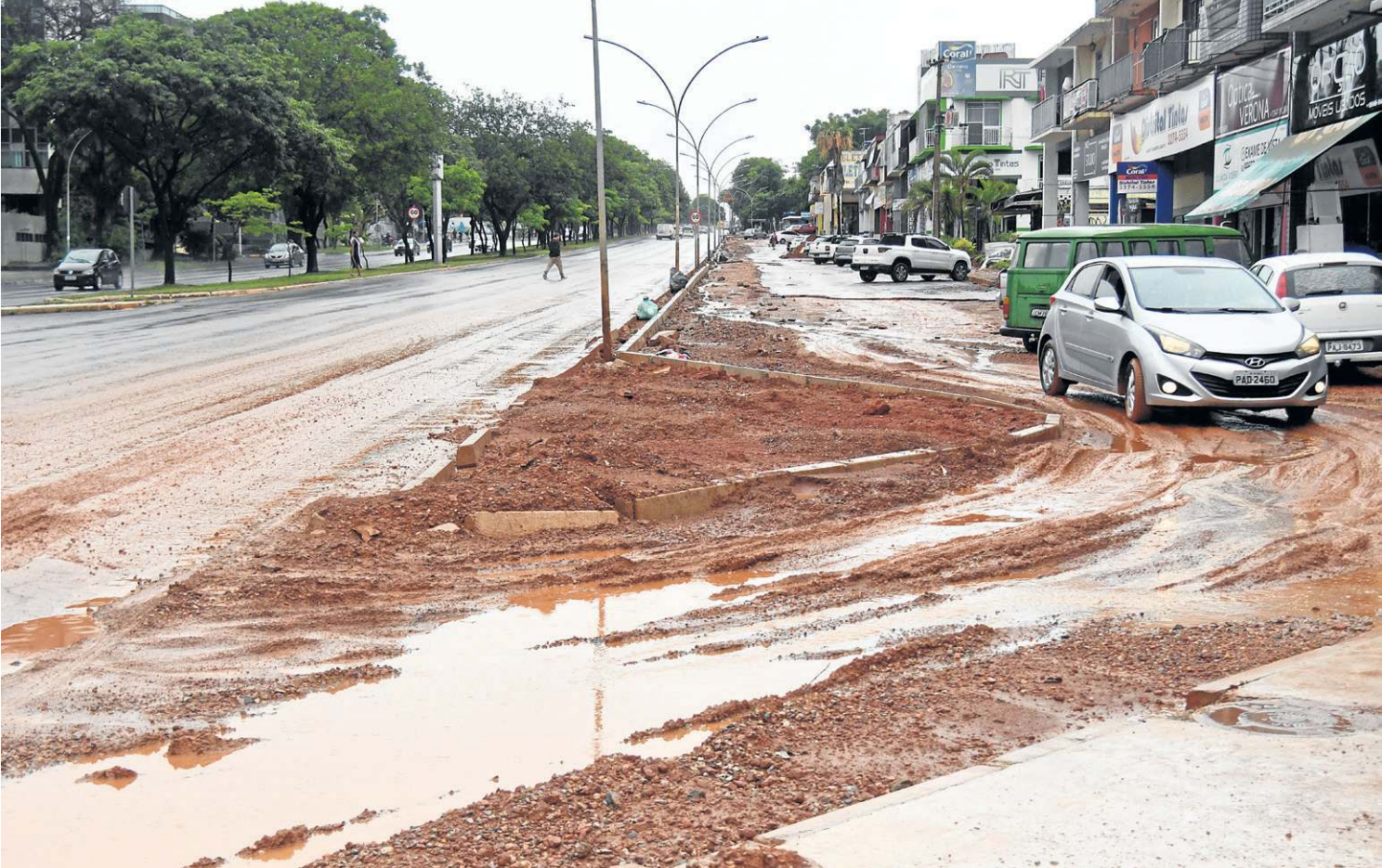
Na 716 Norte, uma obra de revitalização do estacionamento dificulta o trânsito de pedestres e veículos por conta da lama
