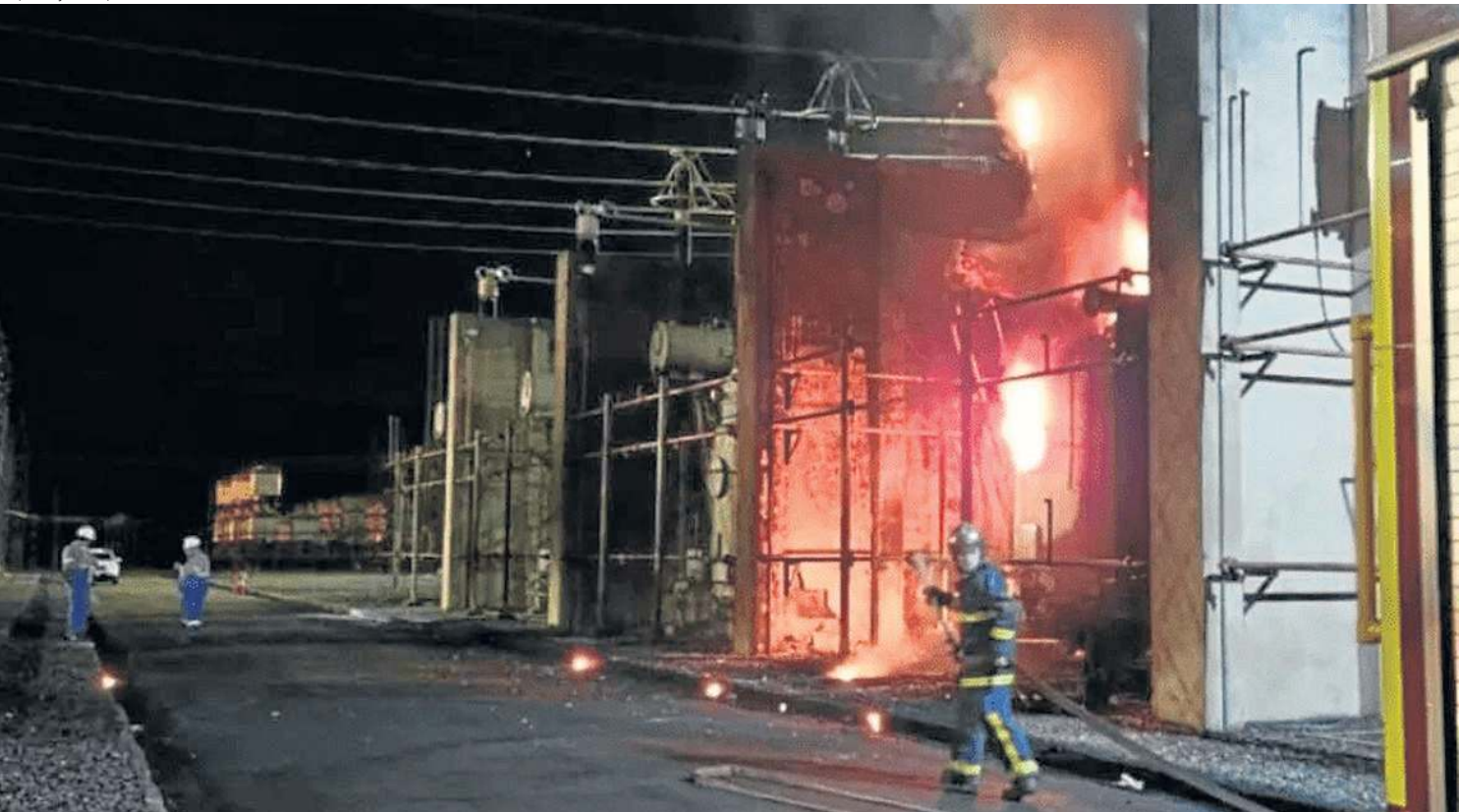
Corpo de Bombeiros tenta controlar incêndio em subestação da Eletrobras no Paraná: investigação apontará se houve negligência no caso
