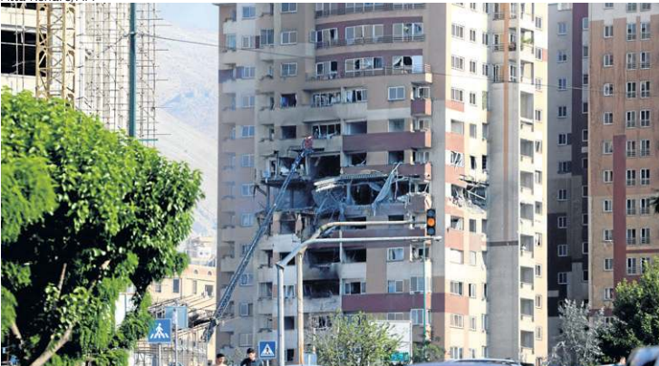
Fachada de prédio danificada em bombardeio israelense, em Teerã
