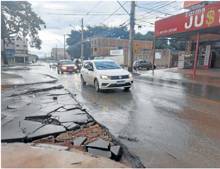
Na EQNP 6/10, a força da água arrancou parte do asfalto
