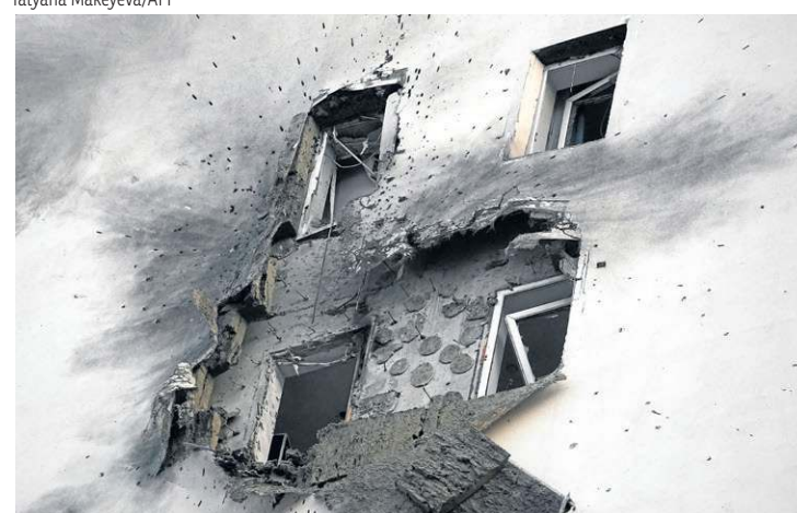
Fachada de prédio danificada por drone no vilarejo de Sapronovo
