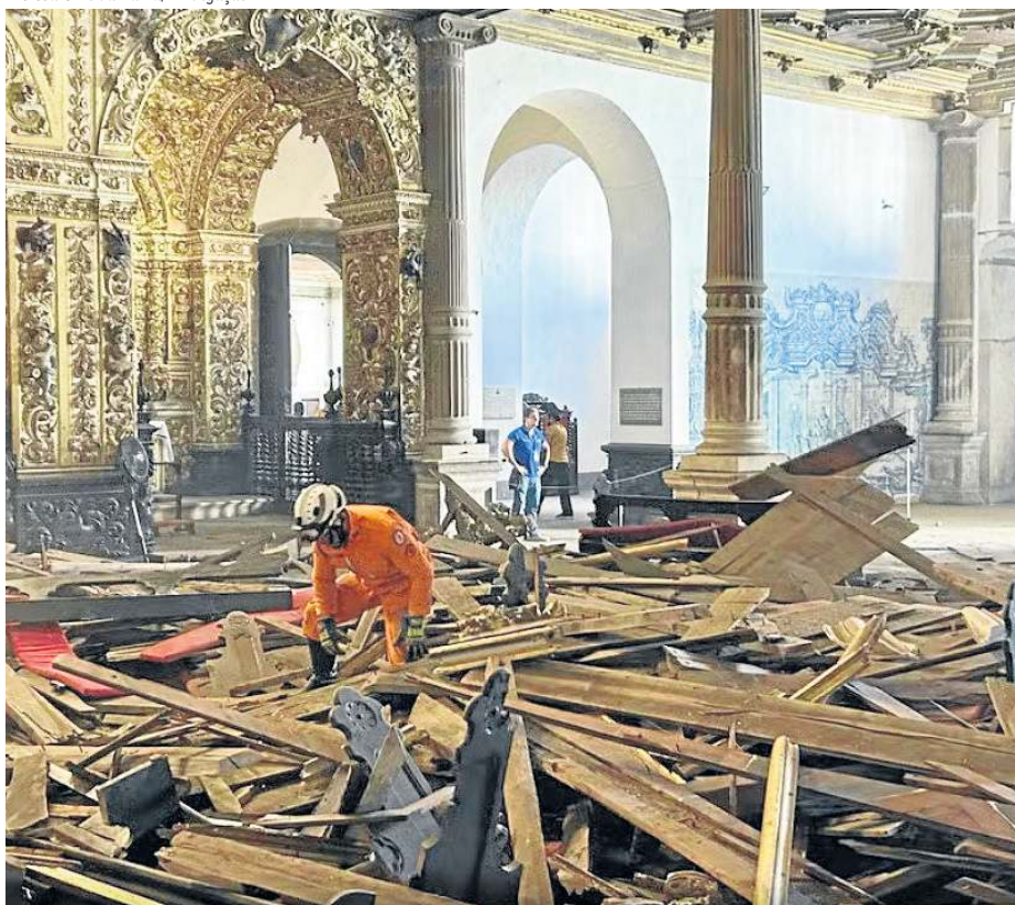
Socorristas verificam os escombros do desabamento do forro da Igreja de São Francisco
