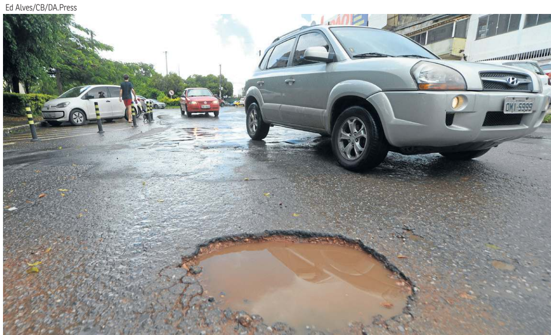
É possível provar na Justiça, juntando provas, que o buraco causou prejuízo e pedir ressarcimento
