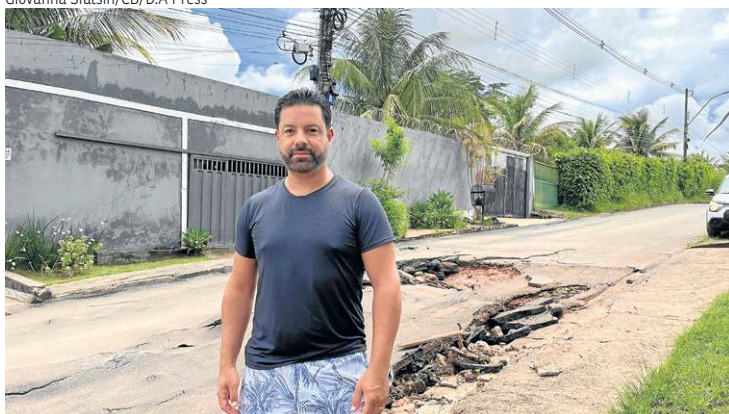
Regis Maciel, de Arniqueiras, reclama das crateras no asfalto
