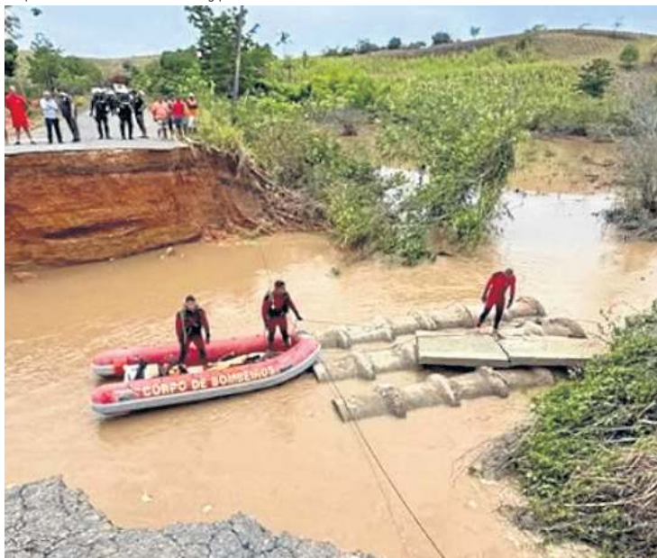
Trecho da SE-438, que desabou em Capela, engoliu dois veículos
