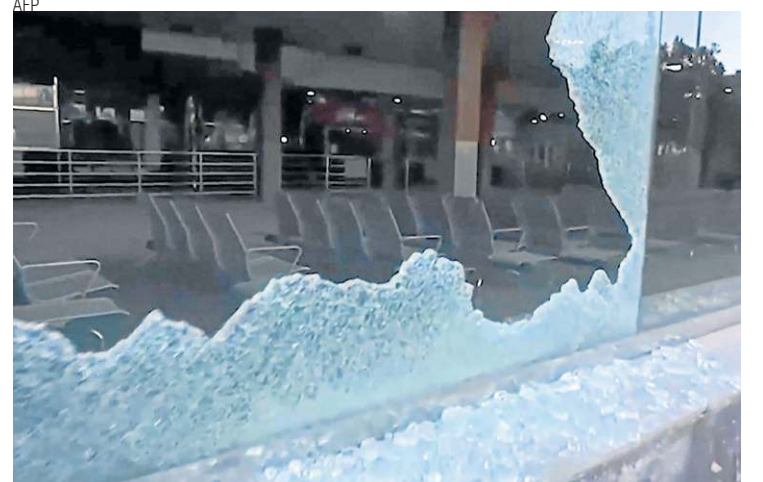
Vidros quebrados na sala de embarque do aeroporto de Sanaã
