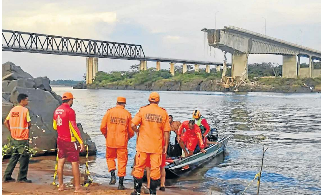
Ponte que liga Tocantins e Maranhão desabou no último domingo. Ao menos 11 pessoas seguem desaparecidas
