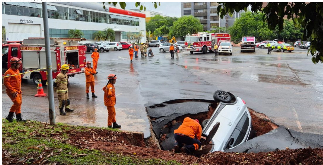
Após chuva forte, asfalto cede e carro é engolido por cratera na 310 Norte. Não houve vítimas
