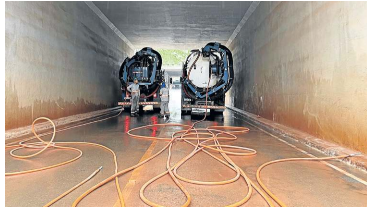
Tesourinha da 102/202 Norte foi interditada para drenagem da água
