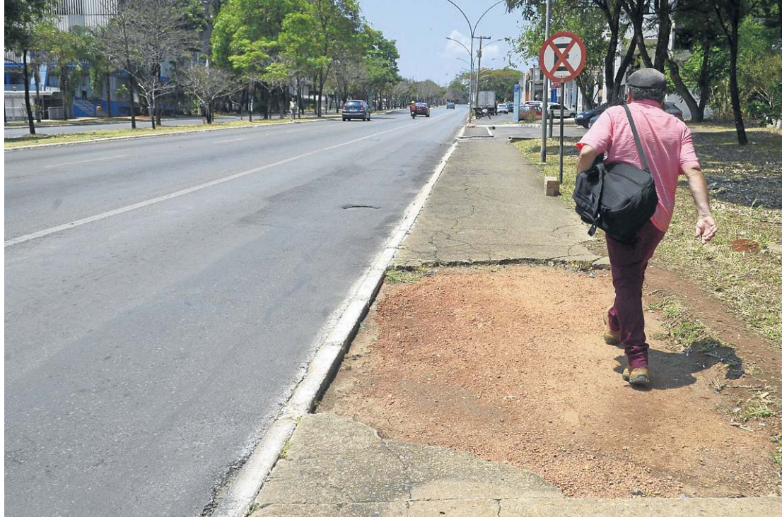
Obras devem resolver problemas como calçadas deterioradas, chão esburacado e falta de rampas
