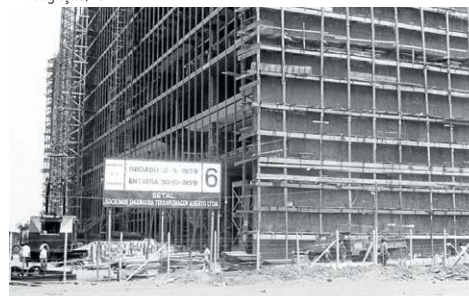
Construção do prédio do Tribunal de Justiça do Distrito Federal e Territórios em 1959
