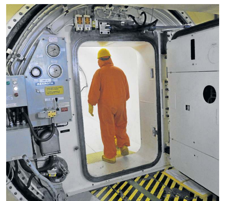
Acesso ao reator de Angra 2: cenário remete à ficção científica
