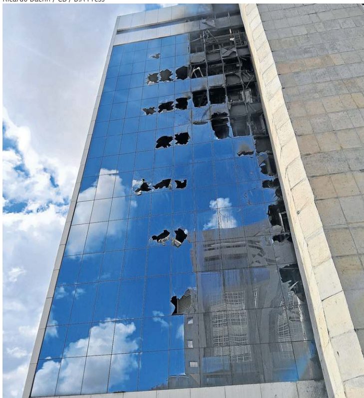
Houve retirada de algumas janelas na operação de combate ao fogo
