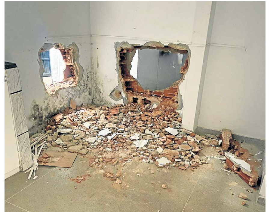
A partir de imóvel ao lado, criminosos escavaram um buraco na parede para acesso a loja
