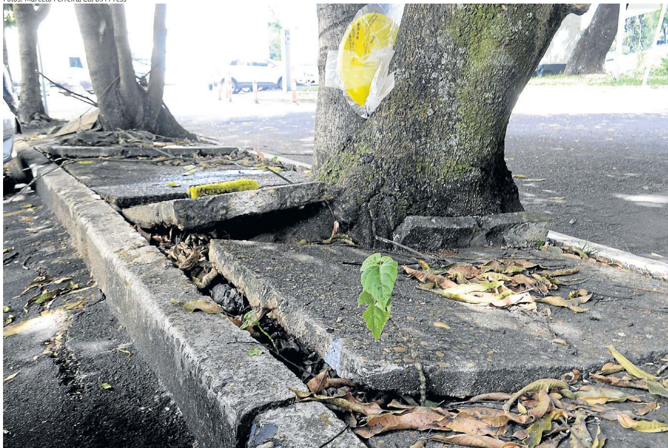
Raízes de árvores rompem o concreto contribuindo para o surgimento de rachaduras na calçada da 304 Sul
