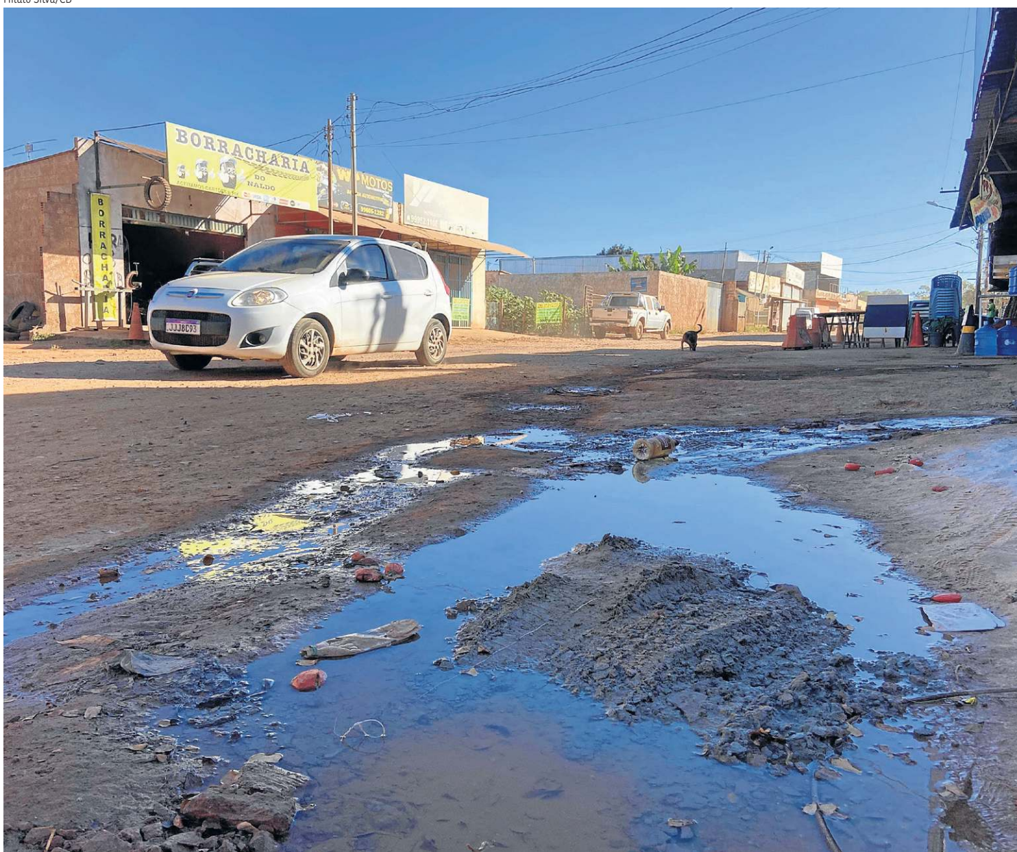
Esgoto a céu aberto no assentamento irregular 26 de Setembro: moradores convivem diariamente com a ausência de saneamento
