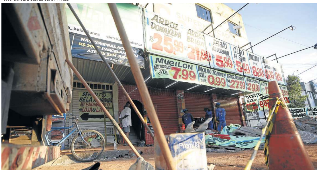
Funcionários da Caesb trabalham para consertar um vazamento de esgoto em frente ao estabelecimento
