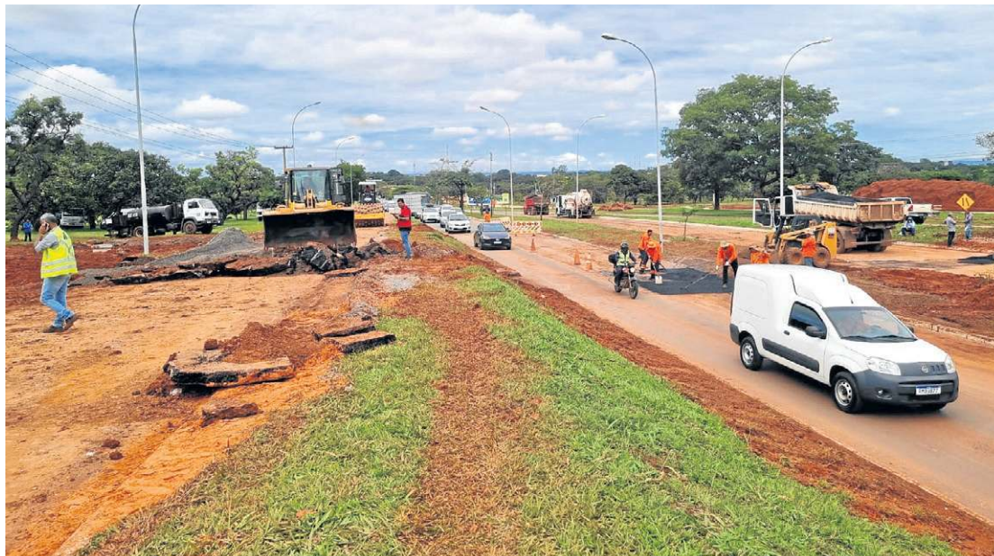
Congestionamento provocado pela obra da Caesb após cratera se abrir no Setor Policial
