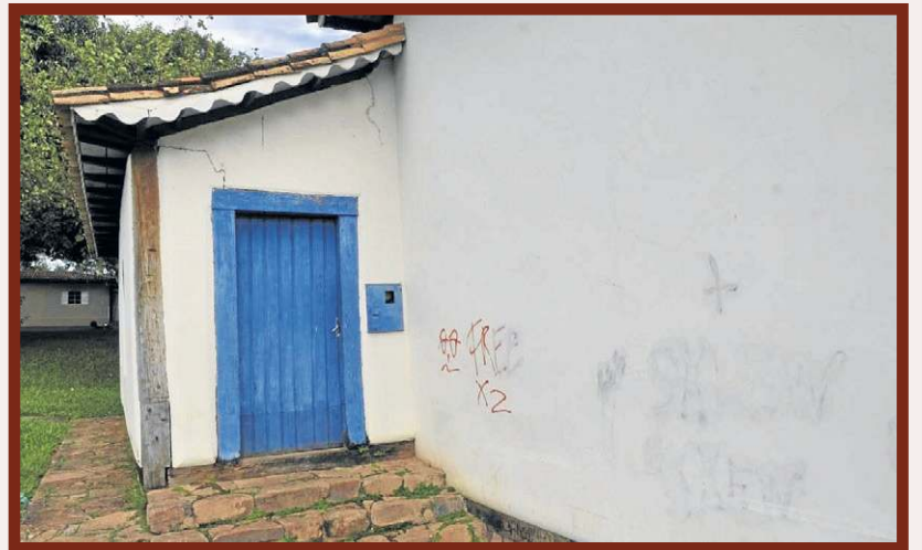
...Mesmo assim, estrutura tem rachaduras e é alvo constante de pichações
