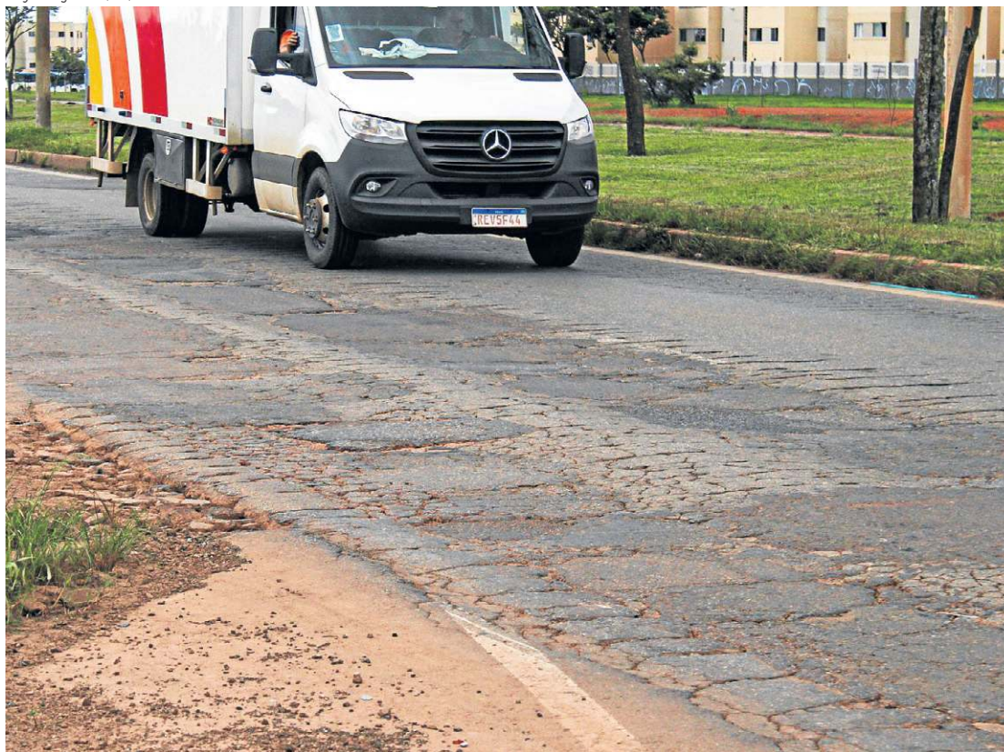
Veículo muda para a faixa contrária para desviar do asfalto danificado
