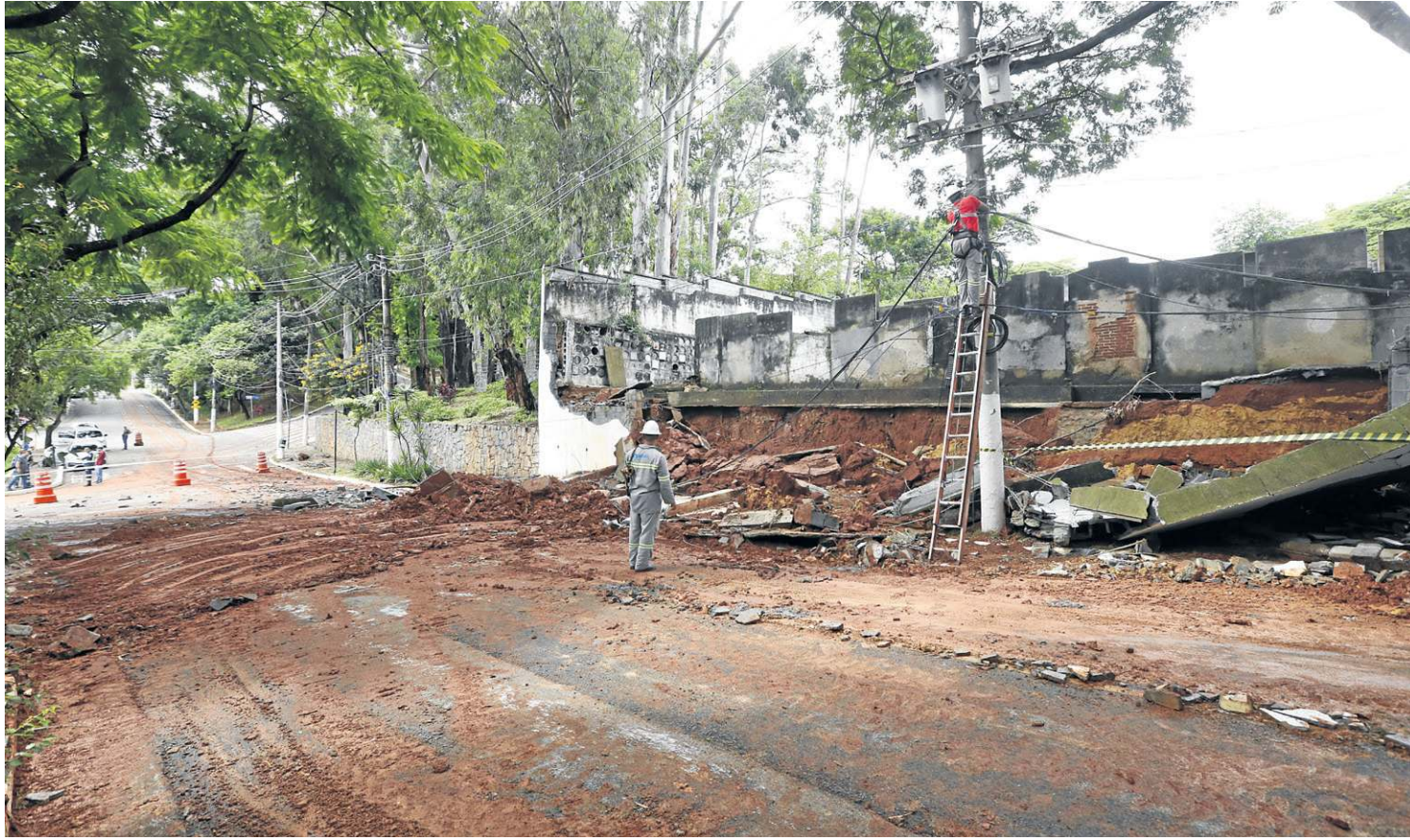
Em São Paulo, as fortes chuvas derrubaram o muro do Cemitério do Araçá. A formação de um ciclone subtropical eleva o risco de enchentes
