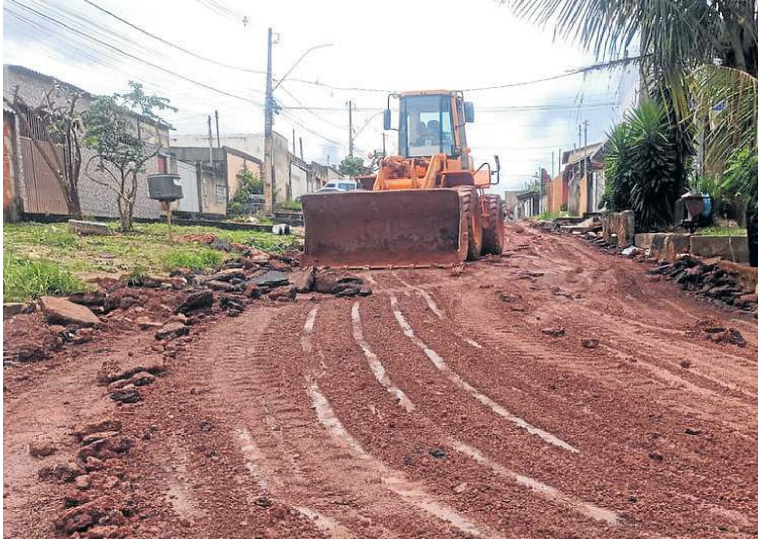
Governo segue reparando danos causados pela chuva no Sol Nascente. Algumas ruas se encheram de lama e outras perderam a cobertura
