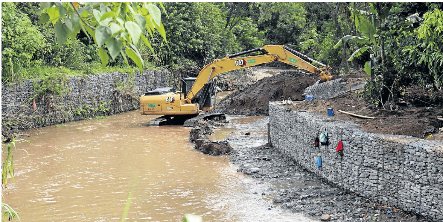
Equipes do GDF reconstruem ponte arrastada pela chuva na Vila Cauhy. Governo assegura estar atento ao problema da comunidade
