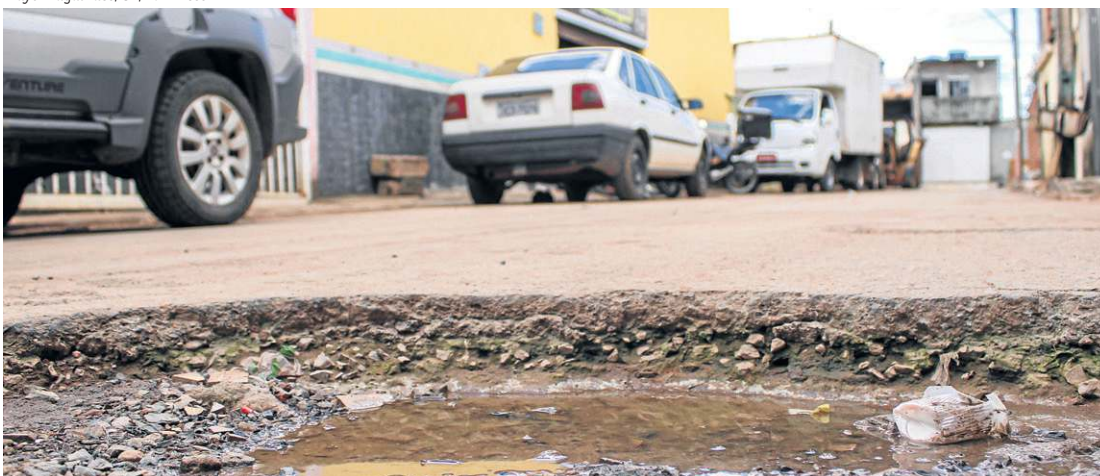
Chuva rompe o asfalto por falta de uma manutenção prévia, avalia especialista em segurança viária
