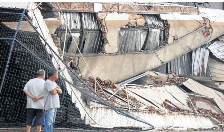
As fortes chuvas provocaram desabamento em Vicente Pires
