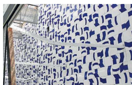
Danos à estrutura de suporte do painel Ventania
