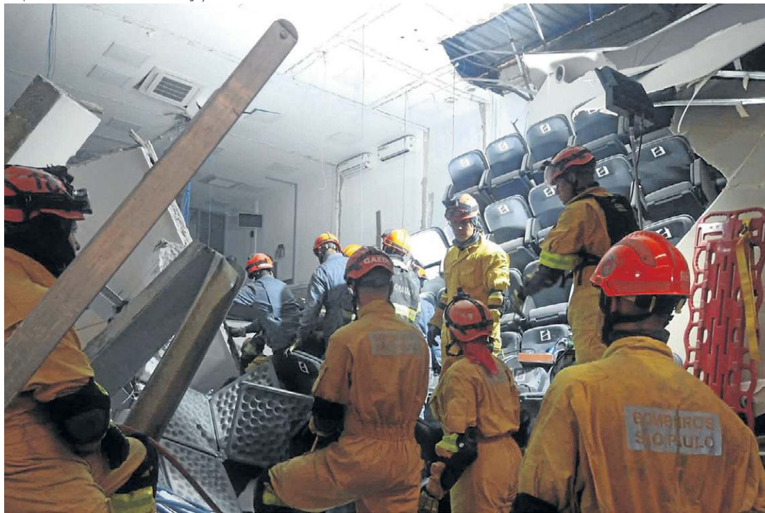
Bombeiros durante operação de resgate das vítimas: auditório não tinha licença para funcionar
