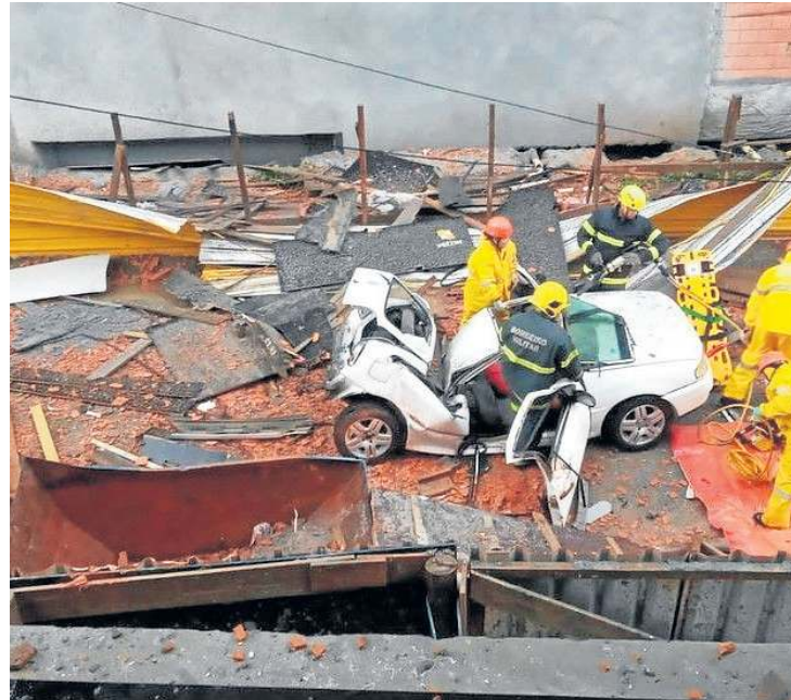
Em Piçarras (SC), bombeiros resgatam motorista ferido em desabamento
