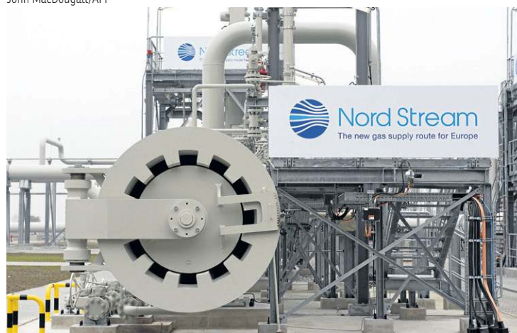
Gasoduto Nord Stream 1, em Lubmin (Alemanha): operação a 20%
