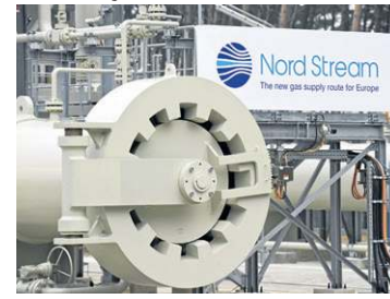
Parte do gasoduto Nord Stream, em Lubmin, no noroeste da Alemanha
