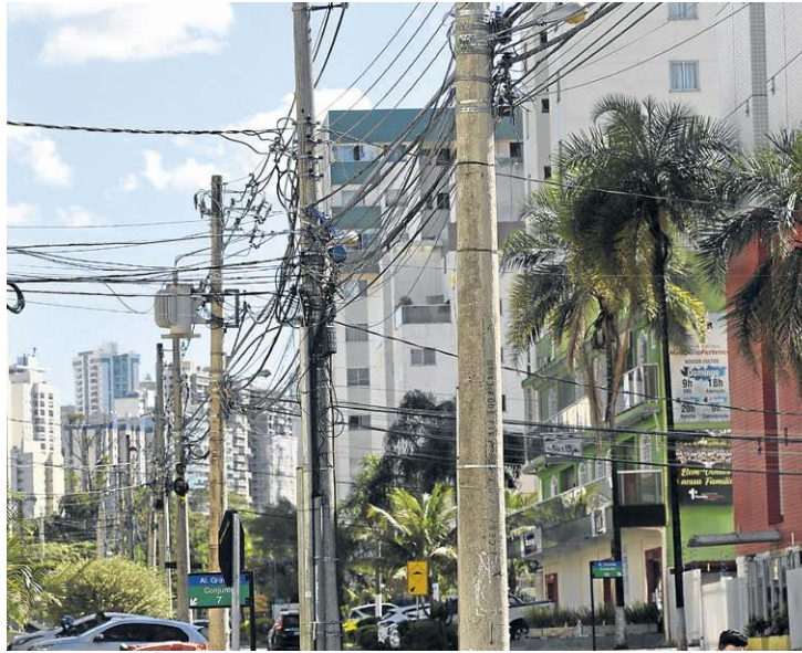
Instalações aéreas se acumulam por serem mais baratas
