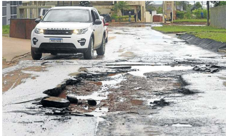
Na Rua 12, água acabou com o asfalto e acesso ficou difícil
