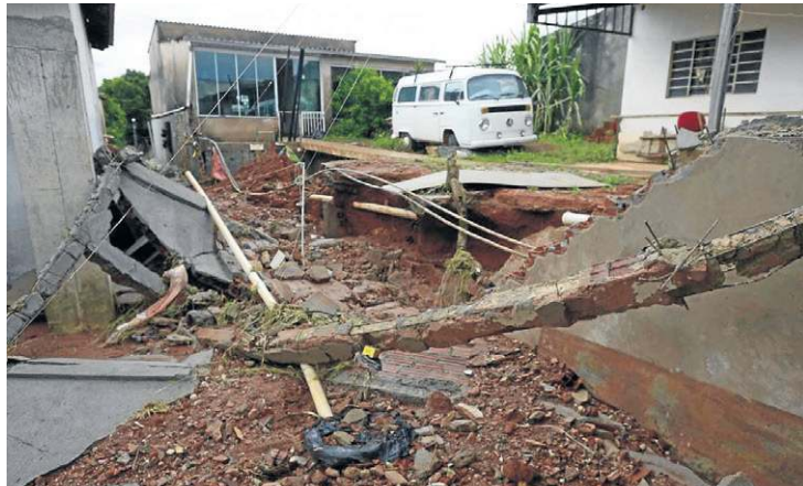
Casas foram invadidas por lama, e na Rua 3 B o muro tombou
