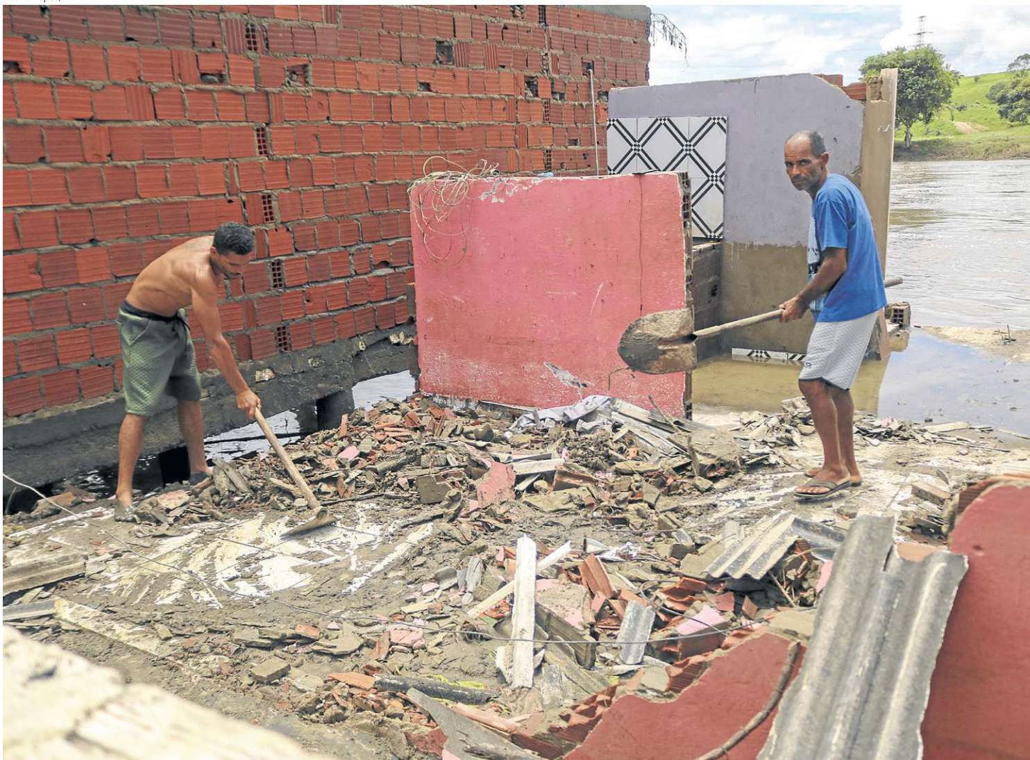
Morador de um bairro de Ilhéus retira o entulho daquilo que foi uma das paredes da casa em que vivia, cuja chuva forte derrubou
